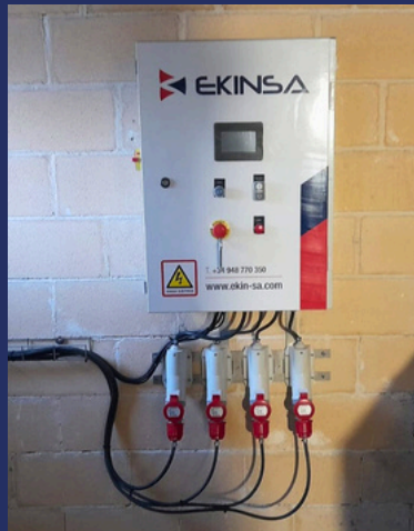
CUADRO DE CONTROL Y PROTECCIÓN PANTALLA TÁCTIL
