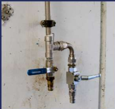
CONEXIÓN A LA INSTALACIÓN
