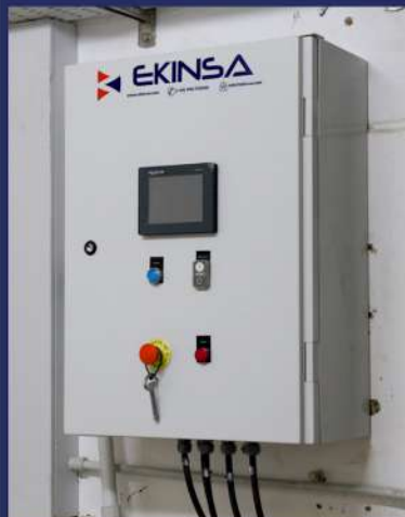
CUADRO DE CONTROL Y PROTECCIÓN PANTALLA TÁCTIL
